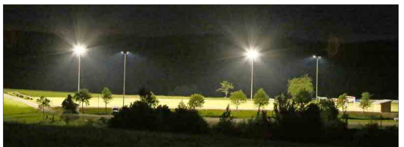
Es werde Licht: Die neue Flutlichtanlage in St. Märgen macht das möglich.
